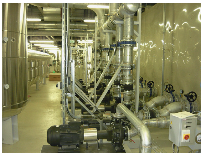
Nyitott hűtési rendszer szivattyúi az energiaközpontban
