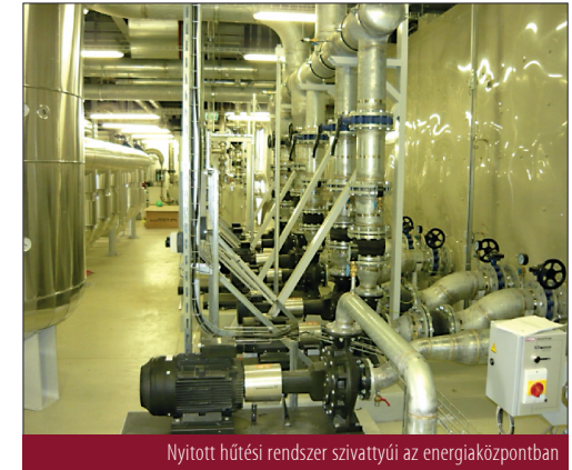
Nyitott hűtési rendszer szivattyúi az energiaközpontban
